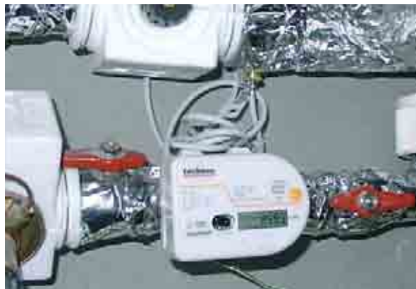
Abb. 5: Gesamt-Wärmemengenzähler an der Installationswand im Technikgeschoss. Das Kabel führt zum Temperaturfühler (Pt 500) in der Vorlaufleitung.
