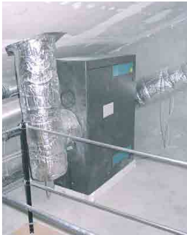
Abbildung 21: Lüftungsgerät mit Wärmerückgewinnung im Technikgeschoss eines Passivhauses in Hannover-Kronsberg. Im Hintergrund das Frischluftrohr mit Defrosterheizung und im Vordergrund das Fortluftrohr (beide mineralwolle gedämmt mit Alukaschierung)
