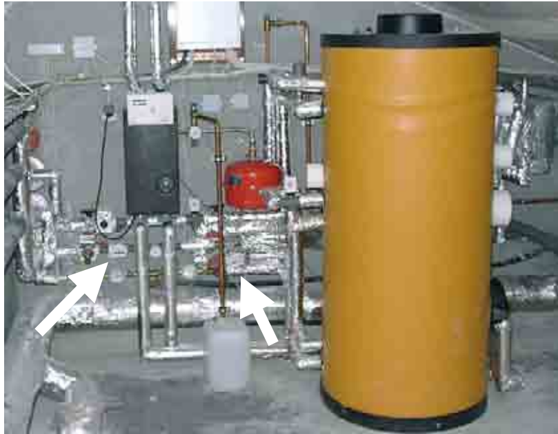
Abb. 4: Installationswand im Technikgeschoss mit Brauchwasserspeicher. Die beiden Wärmemengenzähler sind mit Pfeilen markiert.
