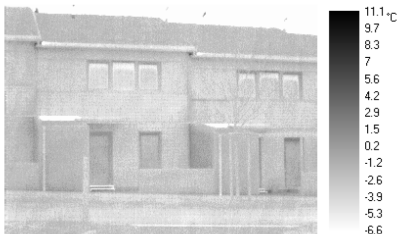
Abbildung 34: Außenthermographie eines Ausschnitts der Häuser von Reihe 9 (Nordseite). Der Bereich unter dem Dachüberstand und unter dem Vordach über der Haustür erscheint wärmer, da diese Bereiche gegenüber der nächtlich kalten Himmelsstrahlung „abgeschattet“ sind. Die Fassaden zeigen ansonsten durchgehend niedrige Temperaturen von etwa -4\text{ °C} .
