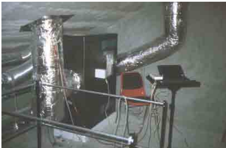
Abbildung 36: Messtechnikaufbau zur Balanceeinstellung des Wärmerückgewinnungsgerätes im Technikgeschoss eines der Passivhäuser. Mittels Druckmessung werden die Volumenströme an den Messkreuzen im Außen- (rechts) und Fortluftrohr (links) festgestellt und abgeglichen. Die Leistung der beiden Ventilatoren wurde einzeln mit dem Bediengerät des Herstellers eingestellt.
