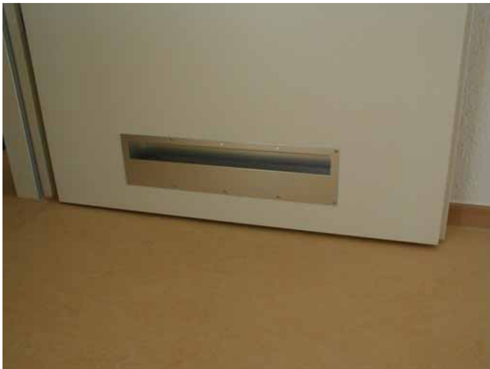
Überströmelement eingebaut in Wohnungstür mit Sichtschutz zum Raum
