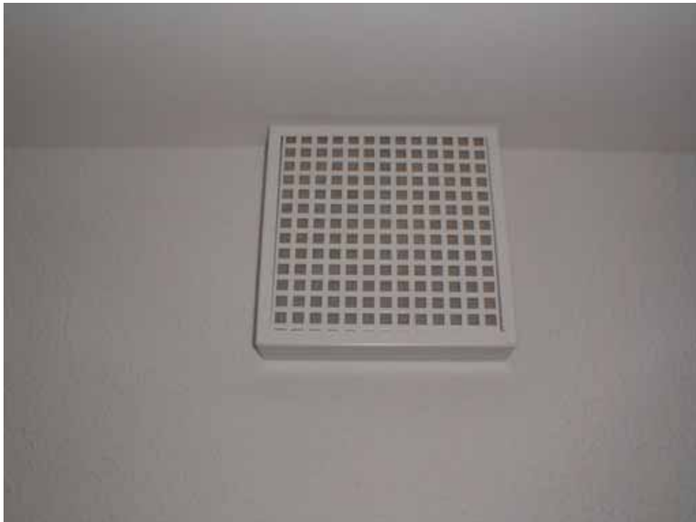
Abluftelement Küche mit vorgeschaltetem G3-Filterelement
