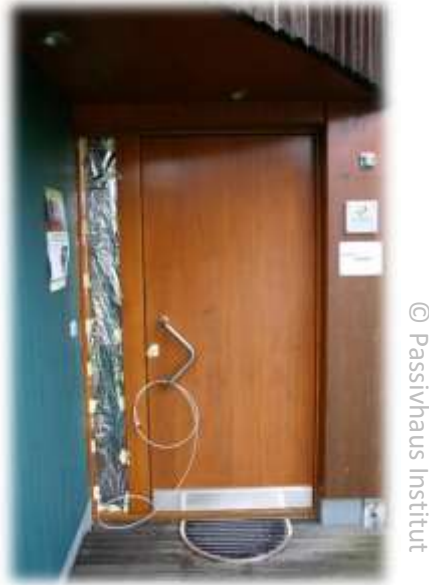
Abbildung 81: Foto von der Eingangstür zum Gebäude: Das Netzkabel zur Kontrolle der Messung ist unter der Türdichtung durchgeführt. Die kleine Seitenscheibe neben der Tür ist mit einer Folie verdunkelt.
