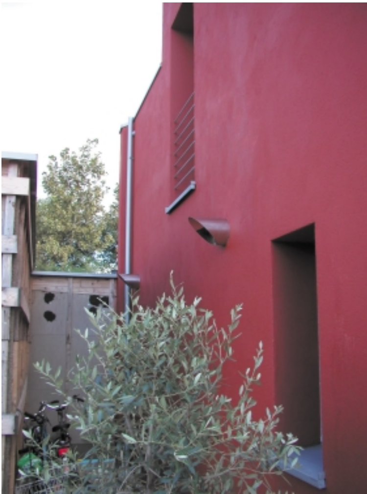
Abb. 98 Außenluftansaugung etwa 2,5 m über Grund. Haus der Familie Müller-Perkuhn, Havixbeck, Architekt: Uwe Müller-Perkuhn, Havixbeck. Foto: ILS NRW, Aachen
