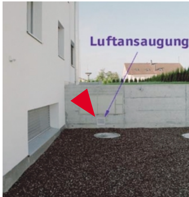
Abb. 97 So nicht! Außenluftansaugung direkt über dem Erdreich verursacht unnötig hohe Staubbelastung. Darüber hinaus ist der Brandschutz zu beachten: Die Luftkanäle müssen einen Mindestabstand zu Fenstern etc. einhalten. Foto: PHI
