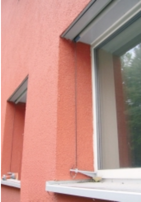
Abb. 68 Fensterlaibung mit Überdämmung des Rahmens und Rollo als Verschattungseinrichtung, Passivhaus Vauban I, Freiburg, Architekten: id-architektur, (Common & Gies Architekten), Freiburg
