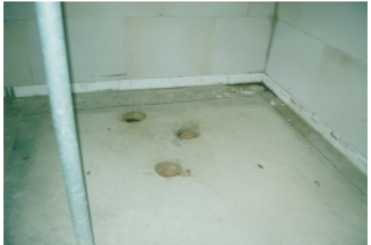
Abb. 33 Fußpunkt einer aufgehenden Wand über Betondecke. Zur thermischen Entkopplung wird die Wand auf eine Reihe Blöcke aus Porenbeton oder ähnlichem Material mit geringer Wärmeleitfähigkeit ( \lambda \leq 0,1 W/(mK)) gestellt. Siehe auch Abbildung 45. Haus der Familie Breuer-Bachmann in Köln, Architekt: Gerhardt Weiss, Aachen. Foto: Breuer-Bachmann
