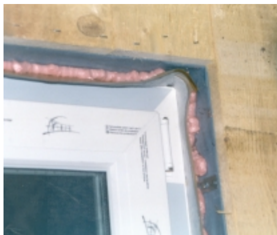
Abb. 52 Luftdichter Fensteranschluss innen, vor der Verklebung der überstehenden Folie am Fensterrahmen mit der Folie unter der Verschalung in der Wand. Der Ortschaum dient lediglich der Verfüllung der Hohlräume und hat nichts mit der Luftdichtheit zu tun! Haus der Familie Hannes in Ruppichteroth, Architekten: Hoppe und Schmidt, Windeck-Hurst. Foto: Hannes
