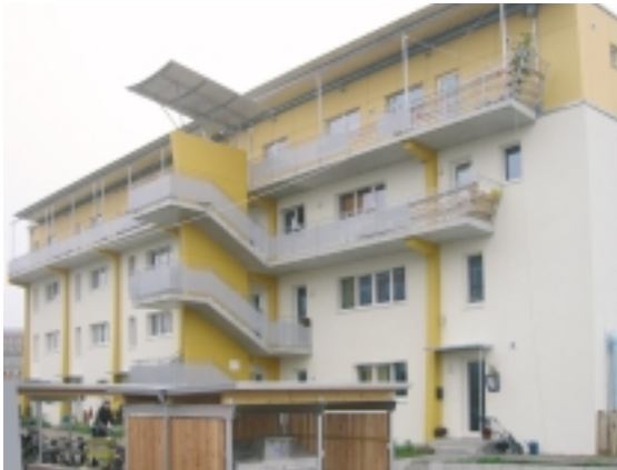
Abb. 13 Galerie und Treppenhaus sind bei diesem Passivhaus auf Betonkonsolen gelagert. Die Konsolen stehen allesamt VOR der wärmedämmenden Hülle (verputztes WDVS im weißen Bereich) und sind nur an wenigen Punkten am Haus verankert. Dadurch werden Wärmebrücken konsequent vermieden. Blick auf die Nordfassade. Das oberste Geschoss (gelb) wurde in Holz-Leichtbauweise erstellt. Passivhaus ISIS, Vauban, Freiburg, Architekt: Meinhard Hansen, Freiburg. Foto: PHI
