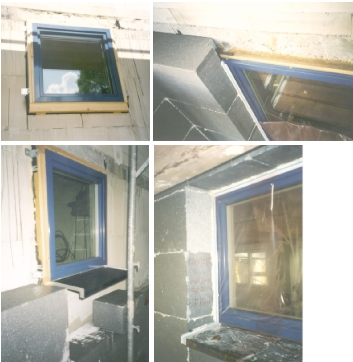
Abb. 84 Fensteranschluss in einem Wärmedämmverbundsystem. Das Fenster wird vor das Mauerwerk gesetzt und dort mit Stahlwinkel­n oder mit einer Konsole befestigt, vgl. Abbildung 67. Die Fensterbank muss, wenn nötig, mit Konsolen trittsicher befestigt werden. In der Brüstung wird die Dämmung bis unter die Fensterbank herangeführt, in der Laibung wird der Rahmen über­dämmt, im dargestellten Beispiel wird der Holzrahmen bis zum Aluminium-Deckprofil mit Dämmung abgedeckt. Haus der Familie Bosmann in Wuppertal, Architektin: Andrea Hoppe, Hoppe und Schäfer, Wuppertal. Fotos: Bosmann
