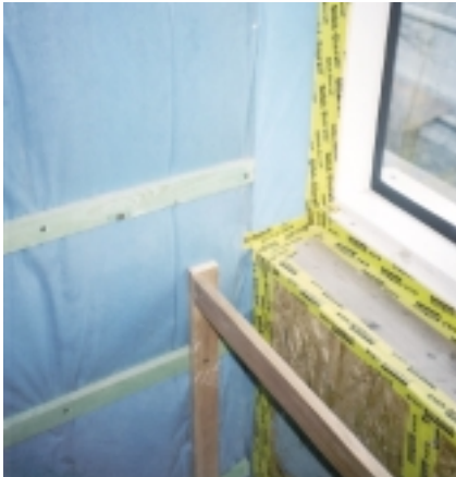
Abb. 53 Fertig verklebtes Fenster. Haus der Familie Hinsenhofen, Detmold, Architekt: H.W. Hinsenhofen, Detmold Foto: Hinsenhofen
