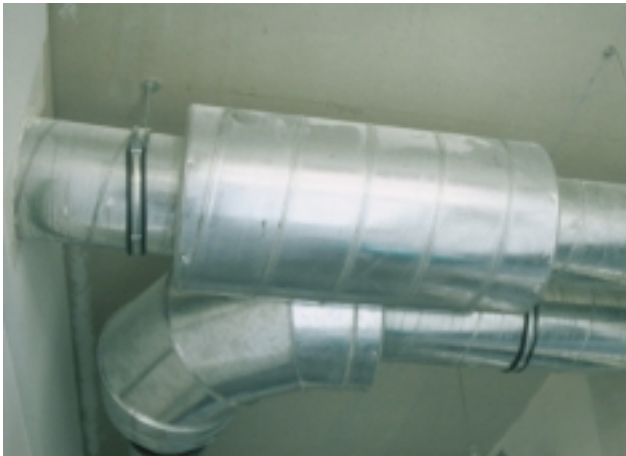
Abb. 78 Telefoneschalldämpfer und andere Komponenten der Lüftungsanlage...
