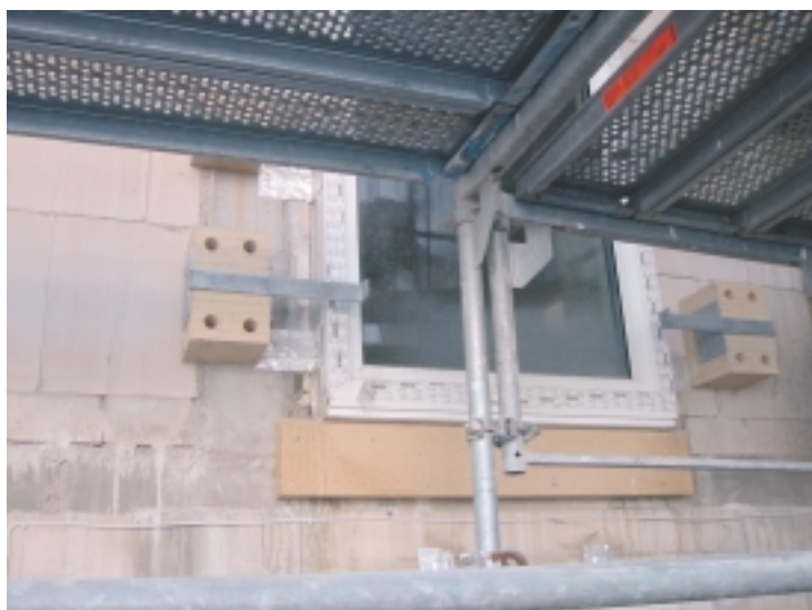
Abb. 35 Konsolen für ein Fenster und ein Geländer (Absturzsicherung) aus hochfestem, wärmedämmendem PU-Recycling-Material ( \lambda = 0,075 \text{ W/(mK)} ). Hamburg, Telemannstraße. Architekten: Dittert und Reumschüssel, Hamburg. Foto: PHI
