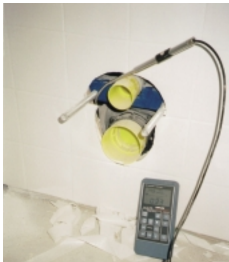
Vorwandinstallation mit nicht lokalisierbarer Leckage. Foto: PHI
