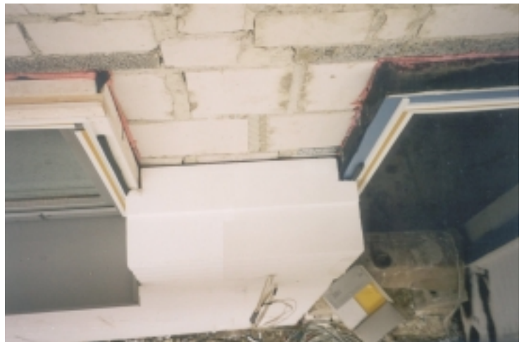
Abb. 34 Die Wärmebrücke am Fensteranschluss kann in der Laibung durch konsequentes Überdämmen des Fensterrahmens sehr effektiv minimiert werden: Das Fenster wird vor dem Mauerwerk befestigt, so dass es später in der Dämmebene liegt. Siehe auch Abbildung 62. Haus der Familie Mainz, Solarsiedlung Aachen. Architekt: Gerhardt Weiss, Aachen. Foto: Mainz
