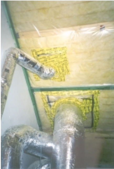
Abb. 90 Vorbildlich: Luftdichte Ebene eindeutig identifizierbar, klare Leitungsführung der Lüftung, Durchdringungen sauber abgeklebt. Haus der Familie Bosmann in Wuppertal, Architektin: Andrea Hoppe, Hoppe und Schäfer, Wuppertal. Foto: Bosmann
