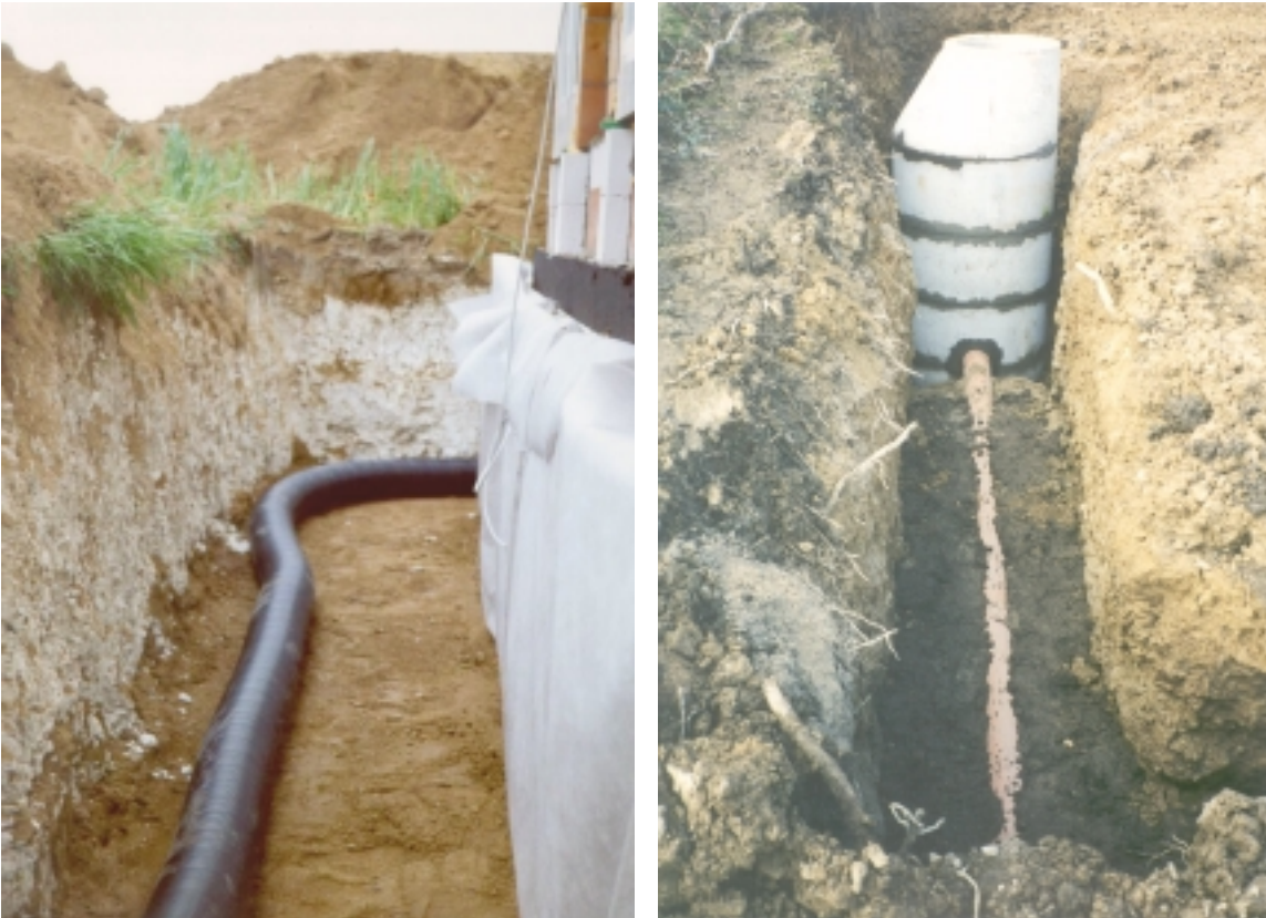
Abb. 101 Erdkanal im Arbeitsraum um das Haus verlegt, auf Luftdichtheit und gleichmäßiges Gefälle der Rohre ohne Mulden ist zu achten.
