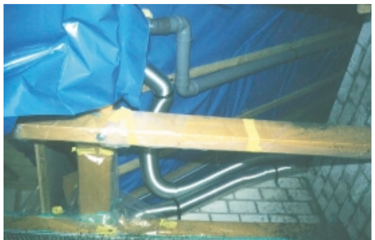
Abb. 89 Diese Anschluss-Situation ist (fast) nicht mehr zu retten, hier kreuzen sich Balken, Lüftungskanäle und Abwasserrohre. Die Lage der luftdichten Ebene ist nicht zu erkennen. Foto: Niedrig-Energie-Institut, Detmold [86]
