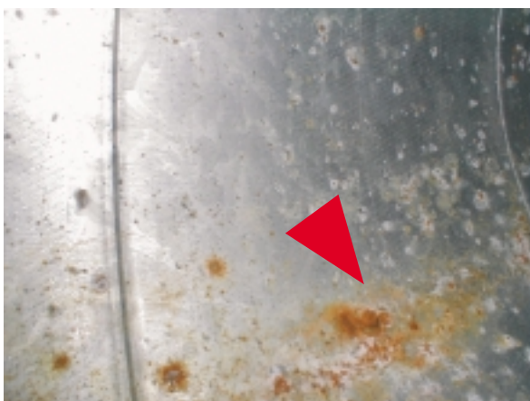
Abb. 94 Korrosionsflecken. Aggressive Medien, wie Mörtel und Zement können die Zinkschicht an Wickelfalzhohr angrreifen und somit zu Korrosion führen, die das Bauteil schnell zerstören kann. Foto: PHI
