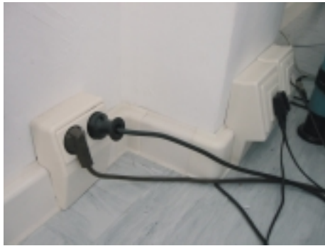
Elektroinstallation als Vorwandinstallation in der Sockelleiste. Foto: PHI
