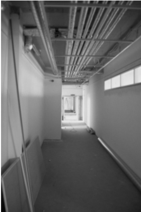
Abb. 25 Wärmeverteilungen und Lüftungskanäle in der abgehängten Decke im Flur eines Passivhaus-Geschosswohnungsbaus. Bei zentralen Wärmeverteilssystemen fallen die Leitungen zwangsläufig länger aus als bei dezentralen Varianten. Dementsprechend sind die Verteilverluste im Energiekonzept zu berücksichtigen [24], [32]. Foto: PHI
