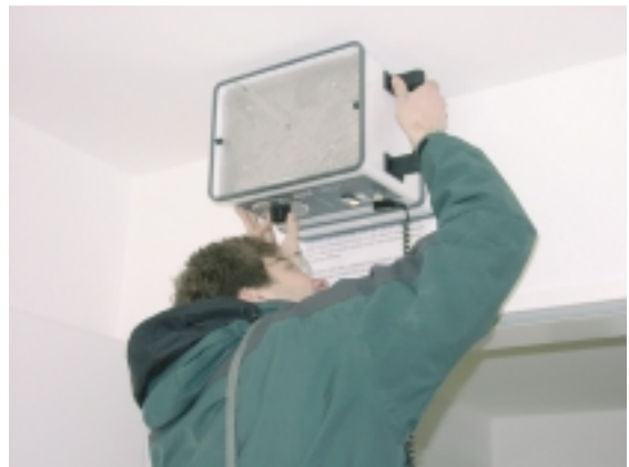
Abb. 99 Messung des Zuluftvolumenstrom an einem Zuluftventil über der Wohnzimmertür. Foto: PHI
