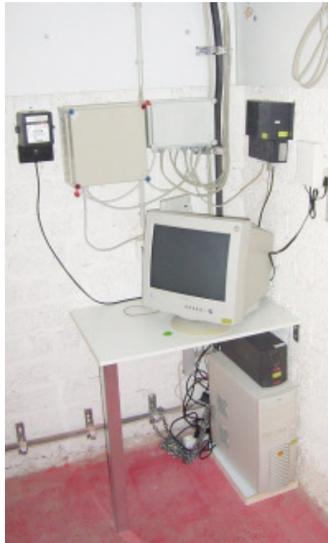
Abbildung 9: Messrechner mit unterbrechungsfreier Stromversorgung (USV), Bus-Master und zentraler Spannungsversorgung der Sensoren sowie Telefonanschluss zum Datentransfer im Keller von Haus 50.
