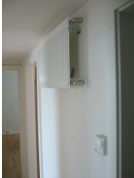
Abbildung 48: Heizkörper an der Flurwand unter der Decke einer EG Wohnung.
