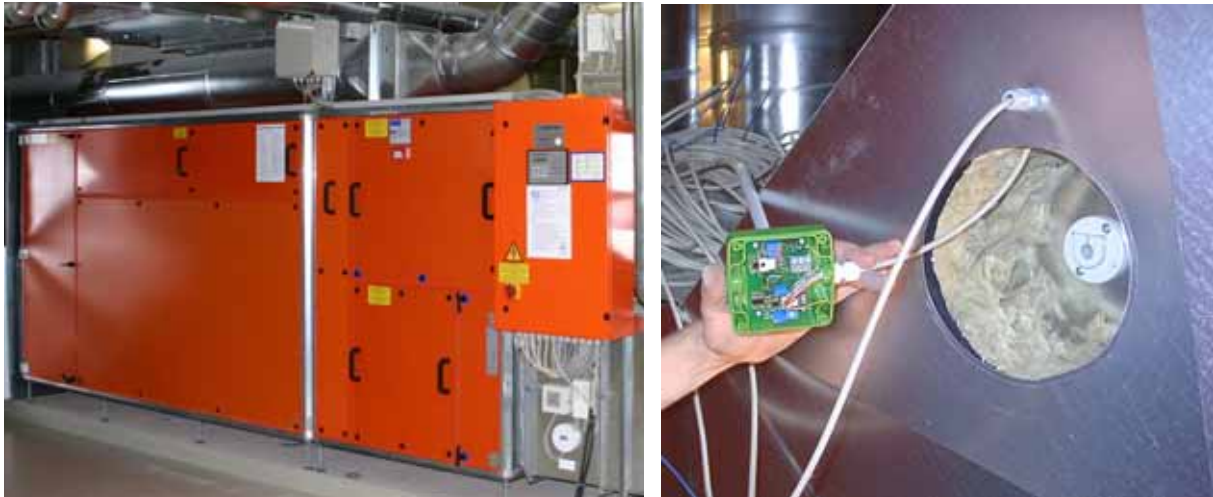
Abbildung 43: Links: Lüftungsgerät „Schule 1“ im Technikeller mit dem darüber montierten Schaltkasten mit der Messtechnik. Rechts: Temperatursensor „Außenluft vor dem Gerät“ während der Montage.
