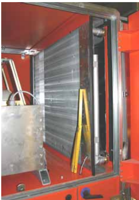
Abbildung 45: Nachheizregister (auch „Frostschutzregister“) im geöffneten Lüftungsgerät vor dem Abgang der Zuluft.
