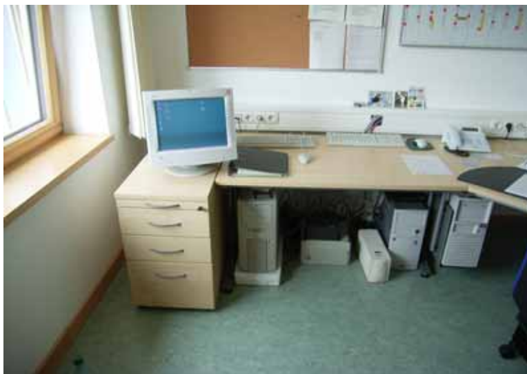
Abbildung 30: Zentraler Messrechner mit Bildschirm und Unterbrechungsfreier Spannungsversorgung (USV) im Büro des Schulhausverwalters (rechts unter dem Tisch: GLT-Rechner und PC des Schulhausverwalters).
