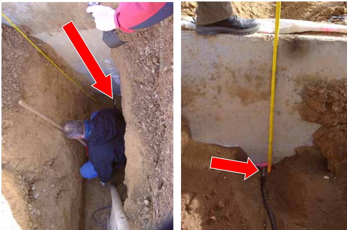
Abbildung 38: Montage der Erdreichtemperatursensoren (hier in Nähe der Dämmschürze) unter der späteren Bodenplatte in unterschiedlichen Tiefen.
