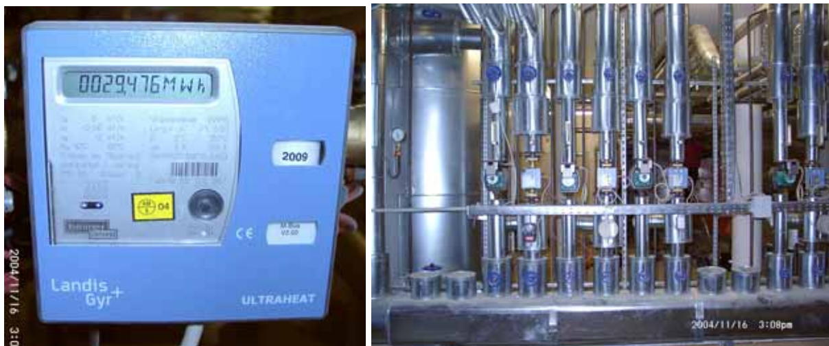
Abbildung 32: Wärmemengenzähler und Teilansicht der hydraulischen Weiche im Technikeller.
