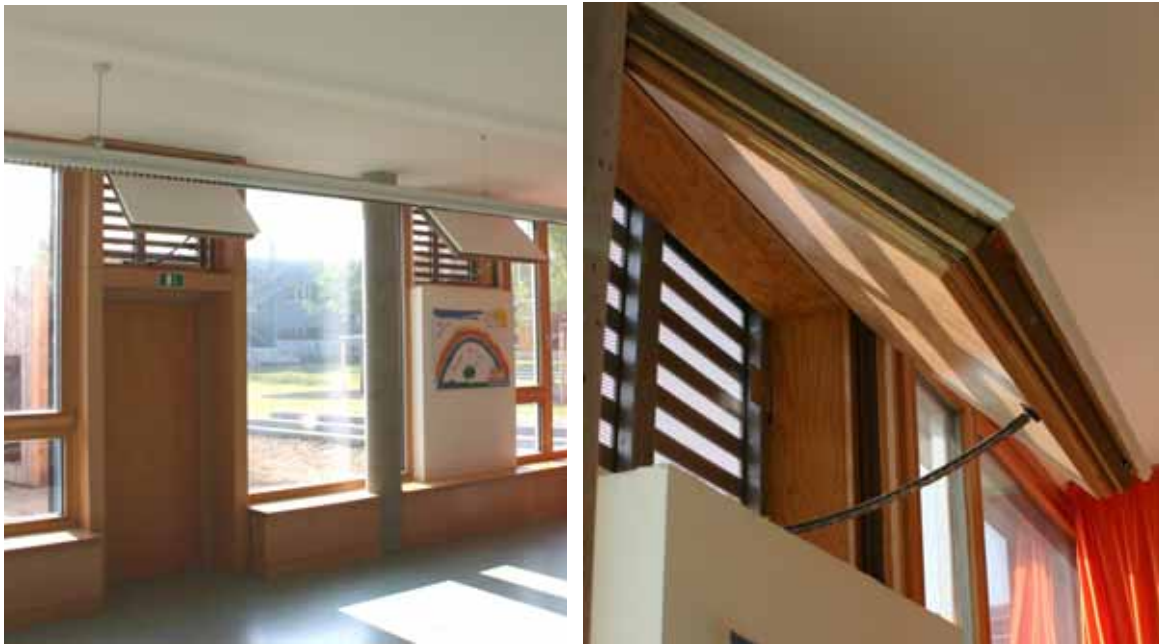
Abbildung 25: Sommerlüftungsklappen (2 Stück je Klassenraum) im weit geöffneten Zustand.
