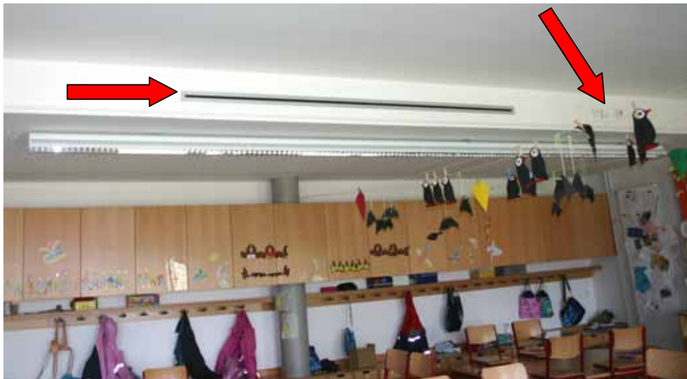
Abbildung 35: Klassenraum mit der Sensorplatte (rechts) und dem Zuluft-Ventil.
