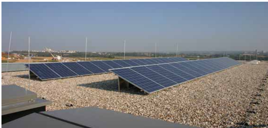
Abbildung 78: PV-Solarstromanlage auf dem Gebäudedach (Nordflügel).
