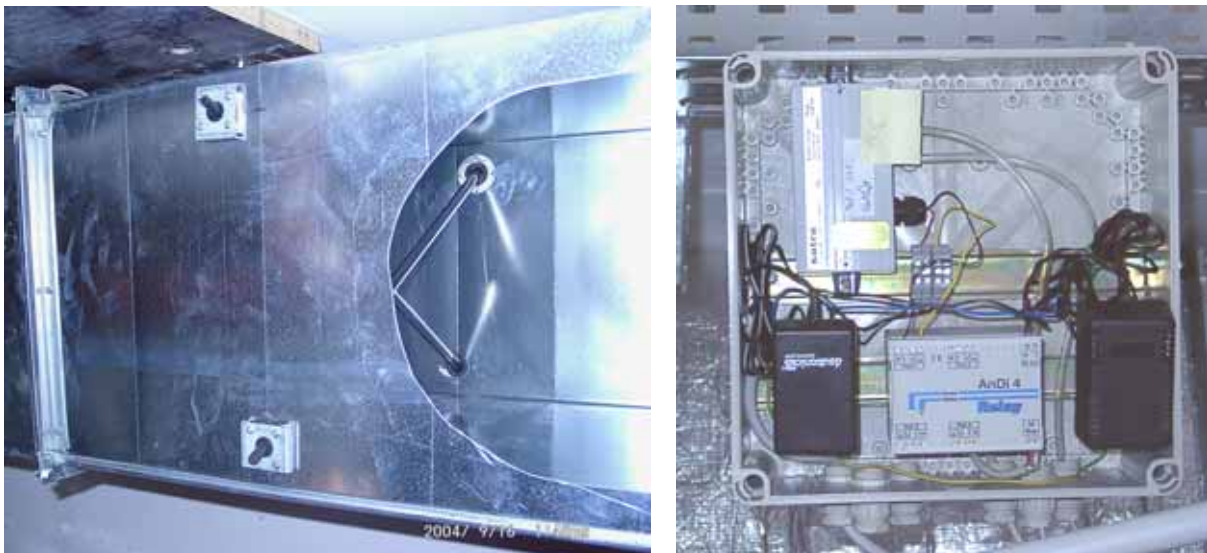
Abbildung 44: Staukreuz im Fortluftkanal vor der Montage der Revisionsklappe und der zugehörige Differenzdrucksensor im Schaltkasten.
