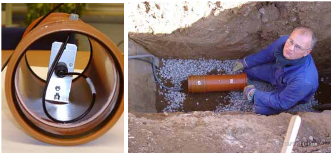
Abbildung 39: Sensor zur Messung der relativen Feuchte im Erdreich. Links: Im Kunststoffrohr montierter Sensor. Rechts: Montage des Sensors im Bereich unter der späteren Bodenplatte.
