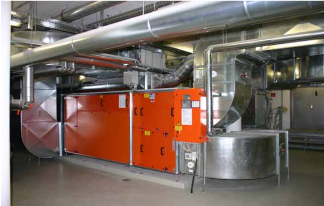
Abbildung 49: Vermessenes Lüftungsgerät „Schule 1“ im Technikkeller der Schule. Rechts im Bild der Zu- und der Abluftkanal. Bei dem runden Kanal über dem Gerät handelt es sich um die Zulufrückführung zur Filtertrocknung.
