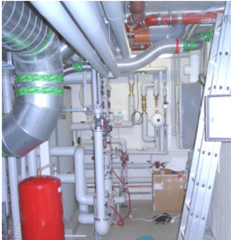
Abbildung 17: Technikraum im DG mit Wärme- und Lüftungszentrale.
