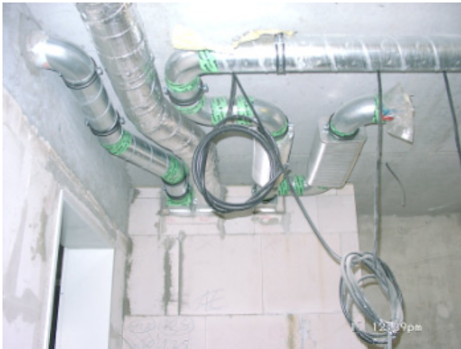
Abbildung 24: Installation der Lüftungsrohre mit Schalldämpfern an der Flurdecke einer Wohnung (Rohbauzustand). Später werden die Rohre im Flurbereich durch eine abgehängte Decke verdeckt.
