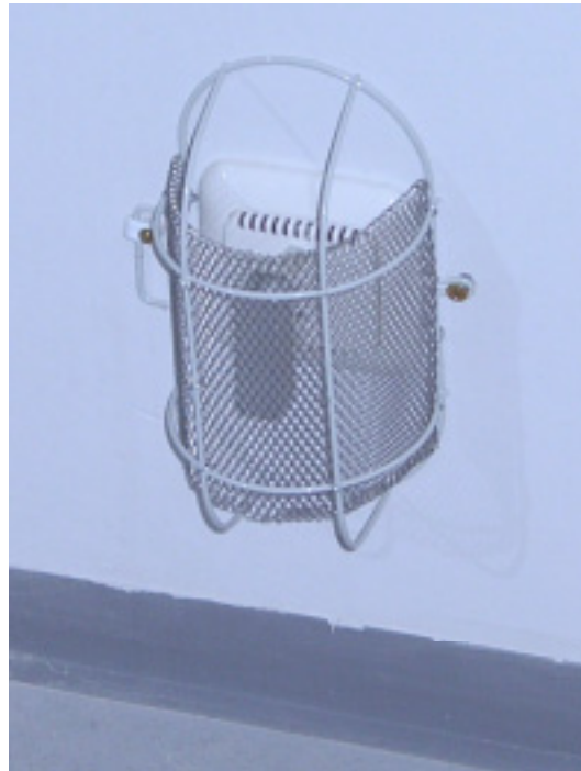
Abbildung 51: Doppelter Sensor für Oberflächen- und Raumlufitemperaturmessung mit einem Schutzgitter gegen Beschädigungen. Diese Ausführung wurde zweimal montiert für die beiden Doppelsensoren in Fußbodennähe in der Außenwand (Nord) des Treppenhauses.
