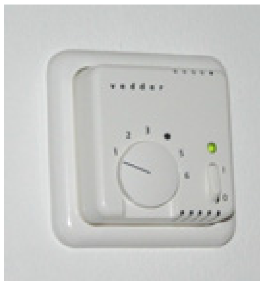
Abbildung 26: Schalter für die Heizungs- und Lüftungsregelung in den Wohnungsfluren. Der Drehschalter dient der Einstellung der Temperatur, mit dem Kippschalter werden zwei der drei Lüftungsstufen eingestellt.
