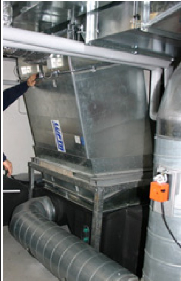
Zentrale Lüftungsanlage in der Technikzentrale im DG
