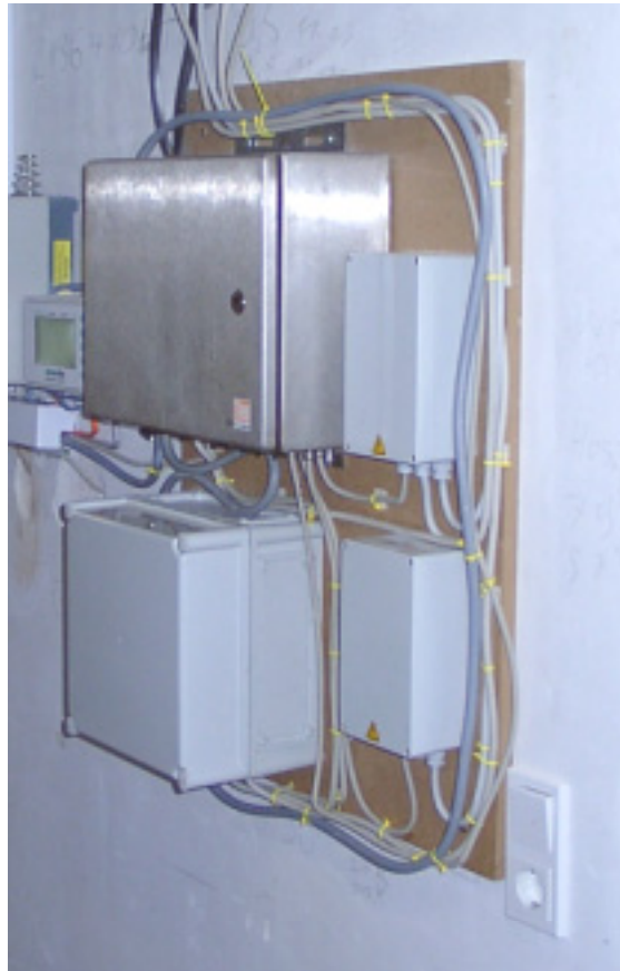
Abbildung 48: Elektronik der Wetterstation im Technikraum DG.
