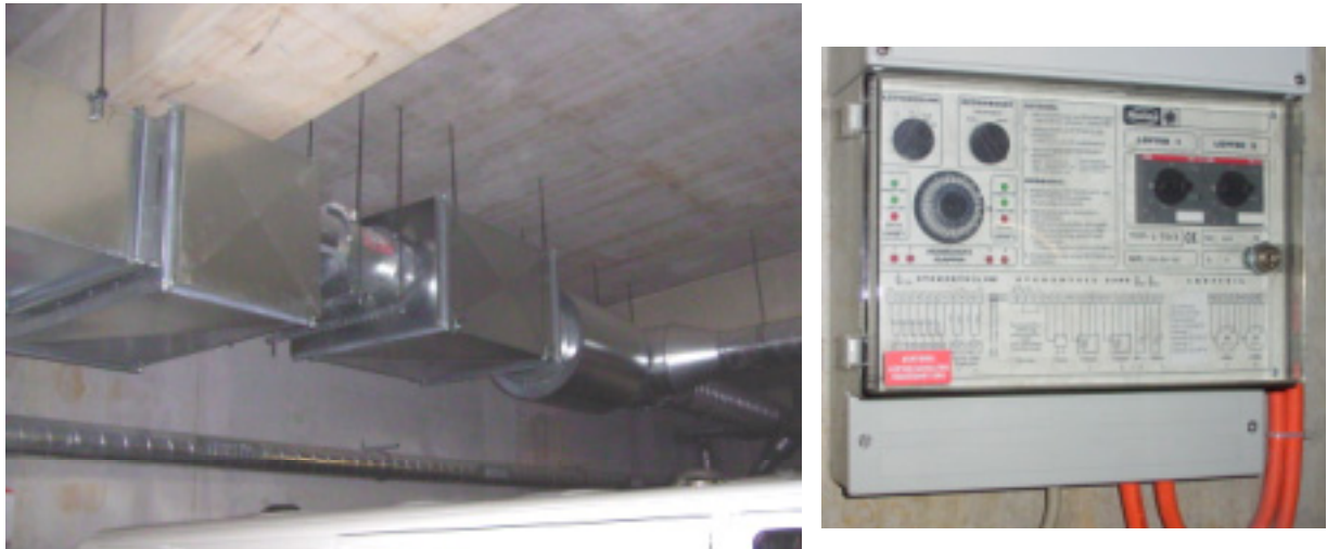
Abbildung 21: Lüftungsanlage für die Quartiersgarage mit Regelung.
