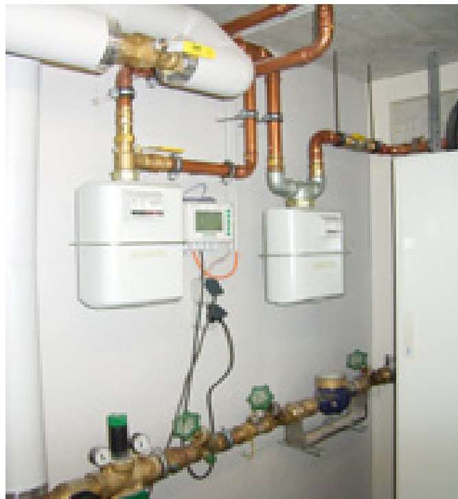
Abbildung 16: Hausanschlussraum mit dem Hauptgaszähler (rechts) und einem Unterzähler für die 8 Gasherde im Gebäude. Unten ist der Hauptwasseranschluss und rechts der Schaltschrank des Hauptstromanschlusses zu erkennen.
