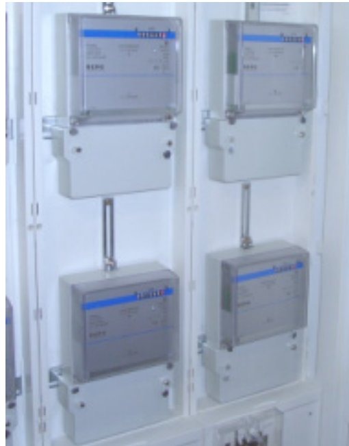
Abbildung 49: Drehstromzähler der einzelnen Haushalte im Hausanschlussraum (Ausschnitt aus dem Zählerfeld).
