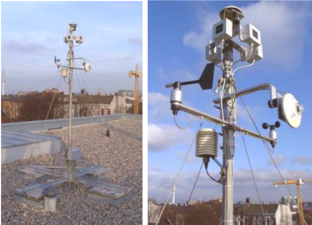
Abbildung 47: Wettermast auf dem Dach des Gebäudes mit Temperatur-, Feuchte-, Wind- und Strahlungssensoren.
