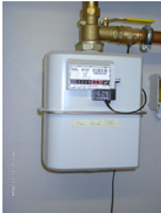
Abbildung 45: Einrohr-Gaszähler mit Impulserfassung (schwarzer Kasten mit Kabel) für den Gasverbrauch der 8 Gasherde.
