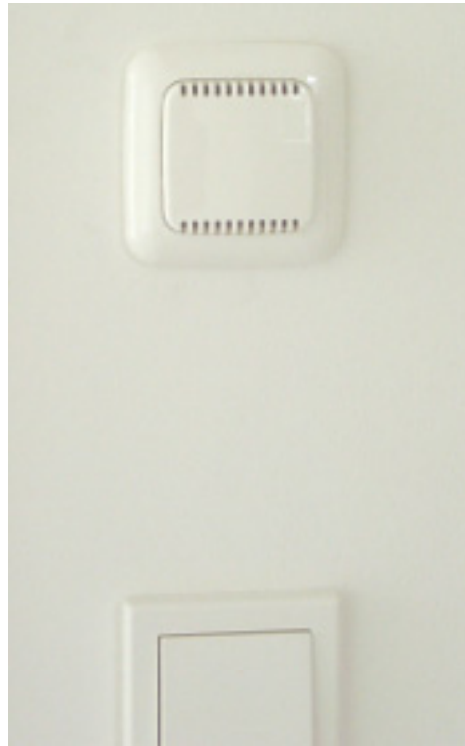
Abbildung 52: Temperatursensor mit geschlitzter Abdeckung über einem Lichtschalter in einer der 19 Wohnungen.
