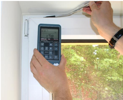
Messung der Luftgeschwindigkeit während des Drucktests an einem noch nicht korrekt justierten Fenster mit einem Thermo-Anemometer.
